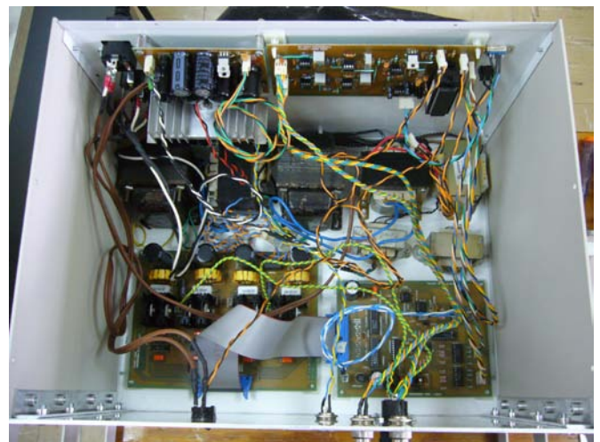
Fig. 12. Interior del gabinete.
