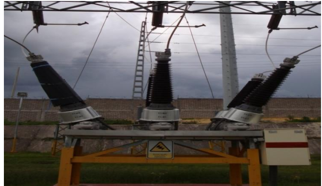
Fig. 11. Interruptor utilizado para probar el sistema de monitoreo y control.
