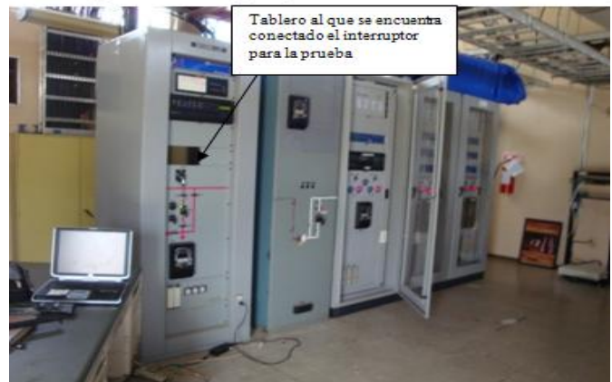
Fig. 12. Interior de la caseta de control de la subestación.
