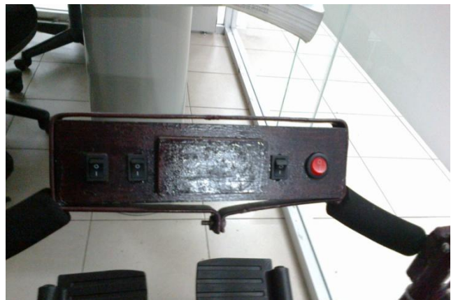
Fig. 7. Tablero de control.
