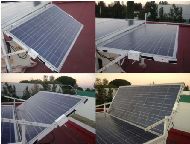
Fig. 1. Celdas solares YL110Wp Yingli Solar instaladas en el techo del laboratorio del ITC.
