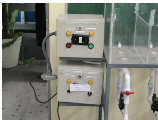
Fig. 3. Tableros de control.
