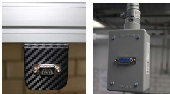
Figura 13 Conectores de señales del sistema construido.
