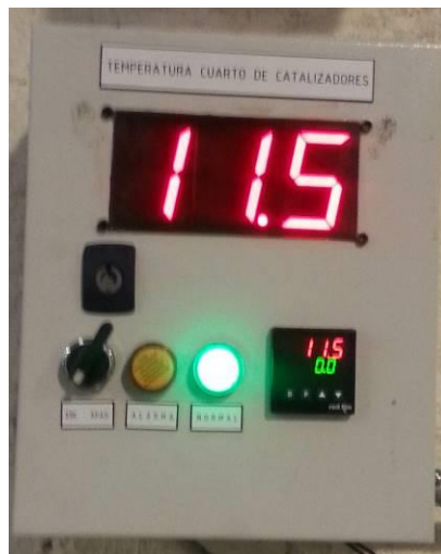
Figura 1 Vista de uno de los equipos instalado en la planta.
